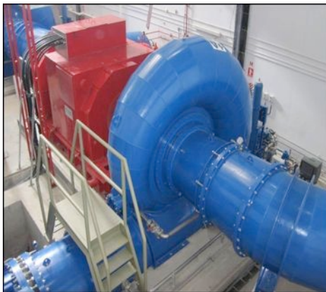
Powerhouse Interior Las Perlas Sud
