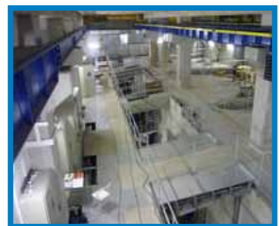
CH Lovosice Interior de la Casa Máquinas
